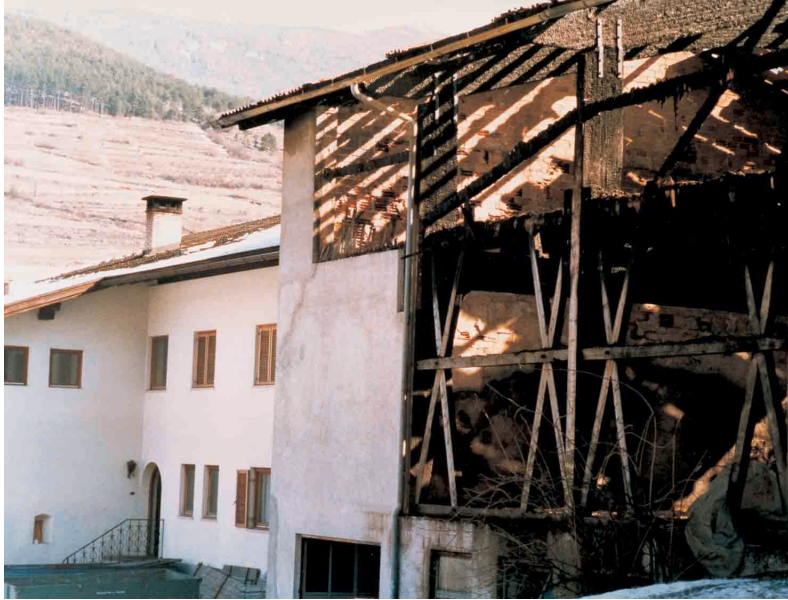
Abb. 15 - Die Brandwand hat die Ausbreitung des Brandes verhindert
