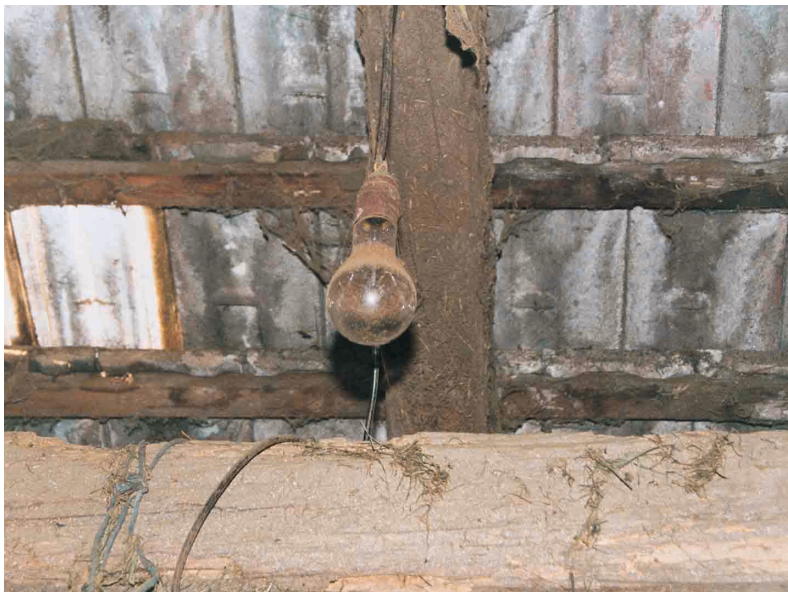
Abb. 10 - Nicht abgedeckte Lampen mit heisser Oberfläche dürfen in staubigen Räumen nicht verwendet werden
