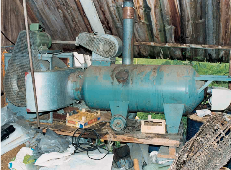
Abb. 4 - Wärmeluftgeneratoren müssen brandsicher aufgestellt werden
